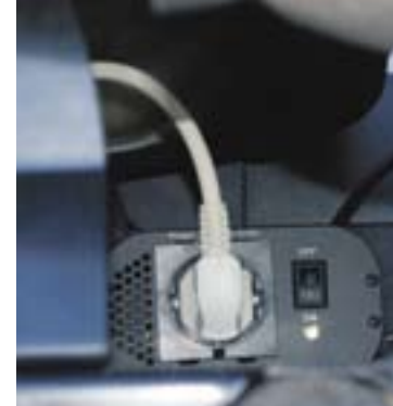
Un transformador elevador (de 12 a 220 V) y rectificador (de corriente continua a alterna) nos permite conectar ordenadores y cargadores de baterías, entre otros útiles.
