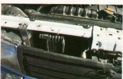
Los Mitsubishi emplean un radiador ubicado por delante del condensador del aire acondicionado y del radiador de agua.
